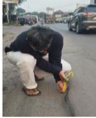
Gambar 19. Kerusakan alur dan retak pada konstruksi perkerasan (Hasil Analisis)
