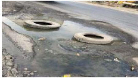
Gambar 16. Kerusakan Lubang (Hasil Analisis)
